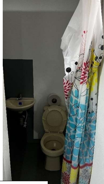
Baño sin puerta
